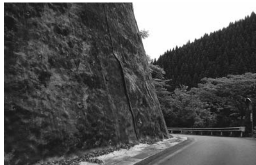
通行止めになっている浜原久保線
