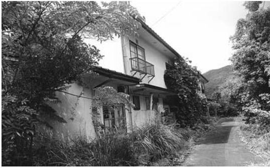
老朽化した町営住宅
